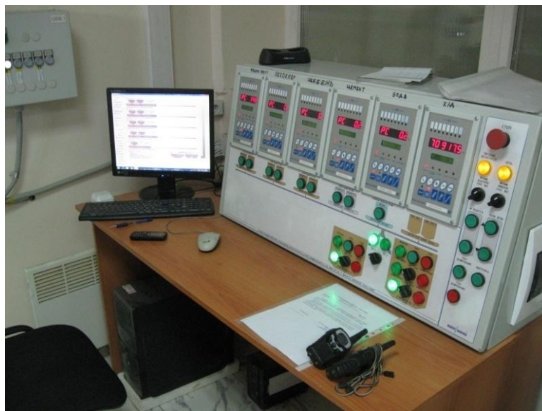
Рис. 4.69. Загальний вигляд пульта оператора диспетчера
